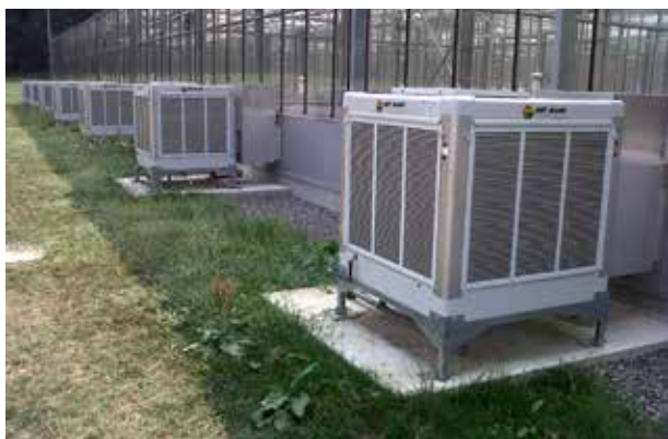
Instalación AD-15-H en un invernadero
