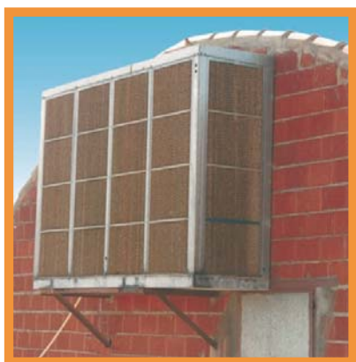
Caseta refrigeración con estructura Inox.
